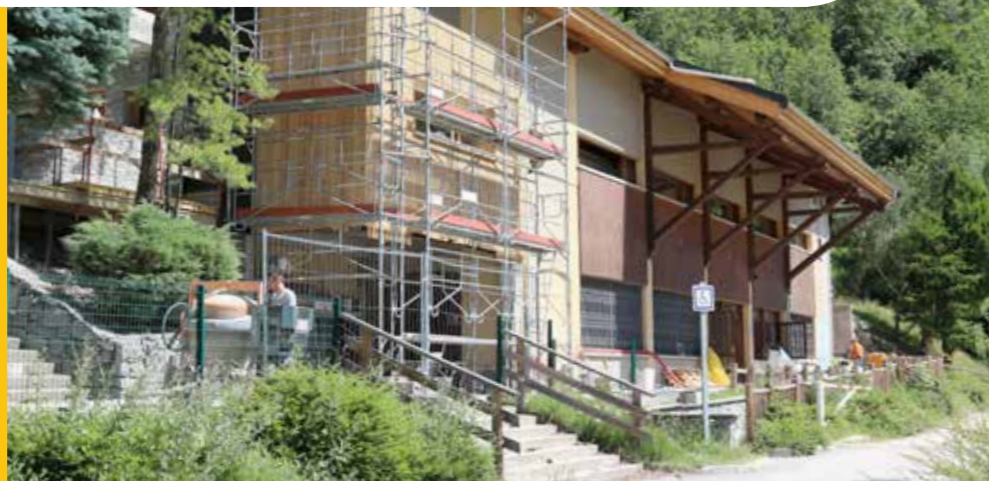
Rénovation énergétique de la salle communale de La Tour-en-Maurienne © Département de la Savoie - Catherine CUDEL
